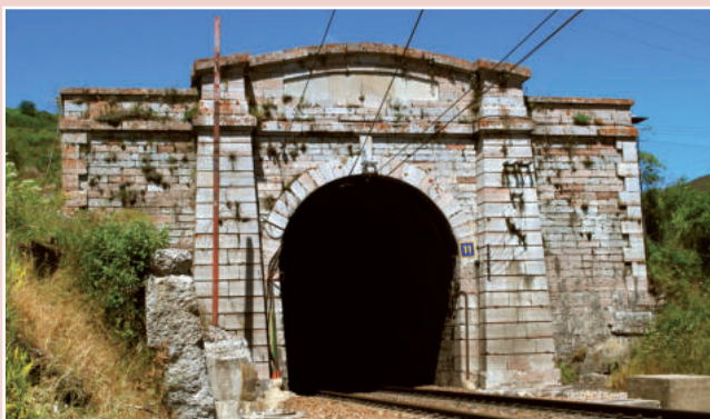
Fig. 3.2.35. Aspecto rosado de la entrada al túnel de La Perruca.
